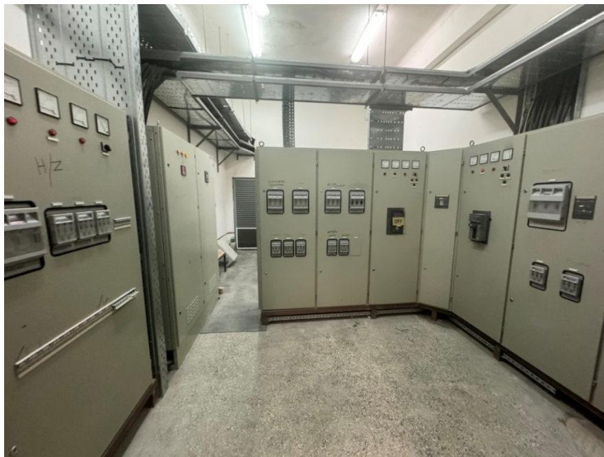
ΠΙΝΑΚΕΣ 2 ο ΥΠΟΣΤΑΘΜΟΥ
