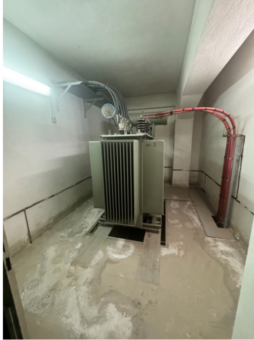
ΜΕΤΑΣΧΗΜΑΤΙΣΤΗΣ ΕΛΑΙΟΥ 1 ου ΥΠΟΣΤΑΘΜΟΥ ΙΣΧΥΟΣ 1000 KVA
