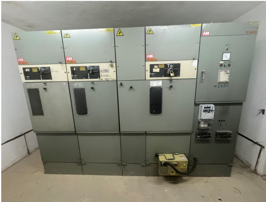
ΠΙΝΑΚΕΣ 1 ο ΥΠΟΣΤΑΘΜΟΥ
