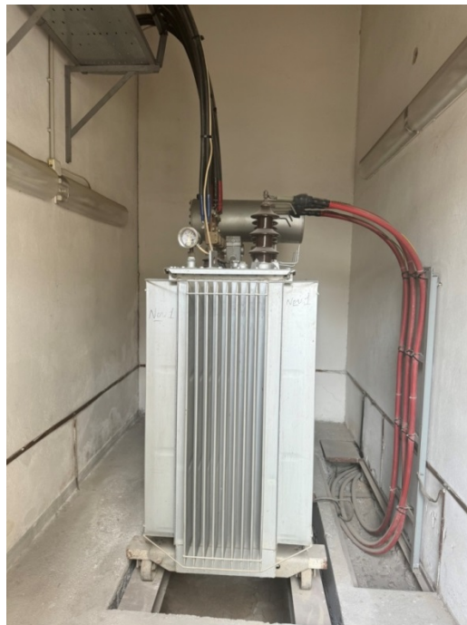
ΜΕΤΑΣΧΗΜΑΤΙΣΤΗΣ ΕΛΑΙΟΥ 2 ου ΥΠΟΣΤΑΘΜΟΥ ΙΣΧΥΟΣ 630KVA (ΙΣΟΓΕΙΟ ΚΤΗΡΙΟ 3Α)
