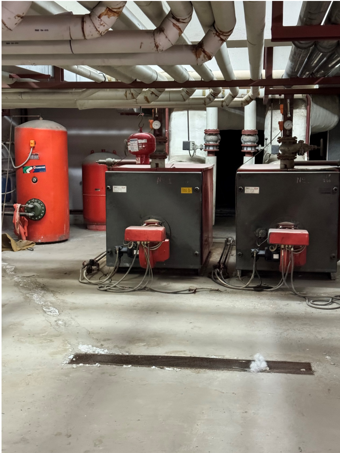
ΧΩΡΟΣ ΛΕΒΗΤΟΣΤΑΣΙΟΥ ΚΑΥΣΤΗΡΩΝ ΚΑΙ ΚΥΚΛΟΦΟΡΗΤΩΝ ΣΤΟ ΥΠΟΓΕΙΟ ΤΟΥ ΚΤΗΡΙΟΥ 2 Α
